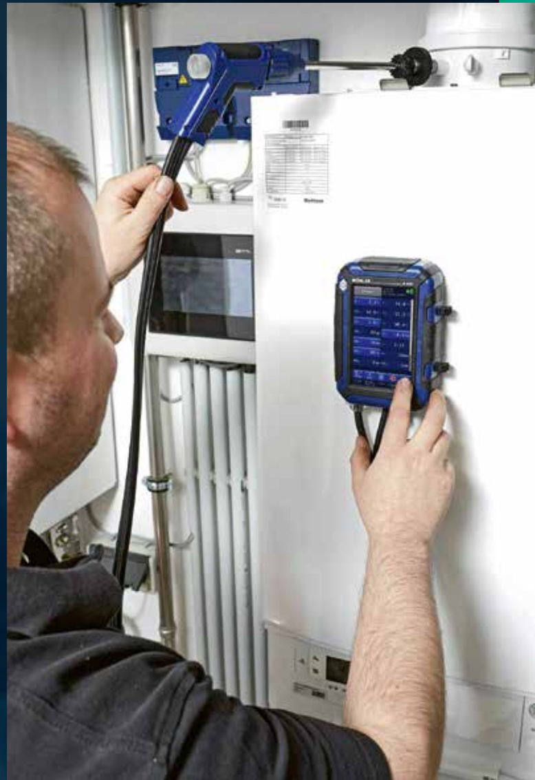
Hier wird eine Abgasmessung an einem Gas-Brennwertgerät durchgeführt. (Bild: Wöhler)
