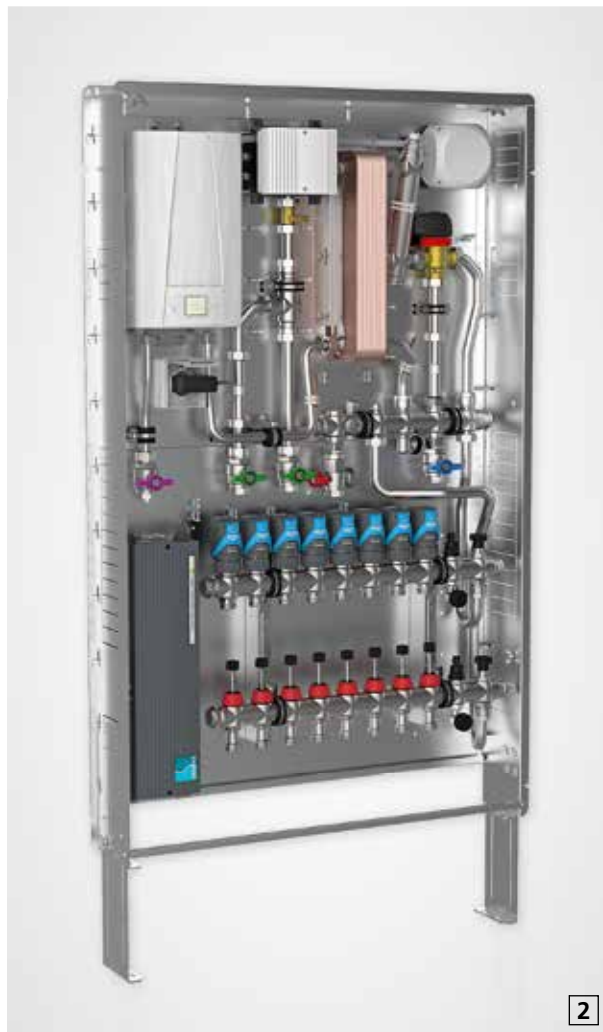
2 Moderne Wohnungsstation mit dezentral-hybrider Trinkwassererwärmung. (Fotos: strawa Wärmetechnik)
