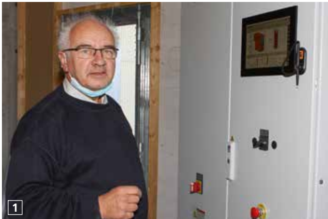
1 Seniorchef Johannes Fäth freut sich über die gelungene Sanierung. Stolz präsentiert der Firmeninhaber die hochmoderne Hackschnitzelanlage.
